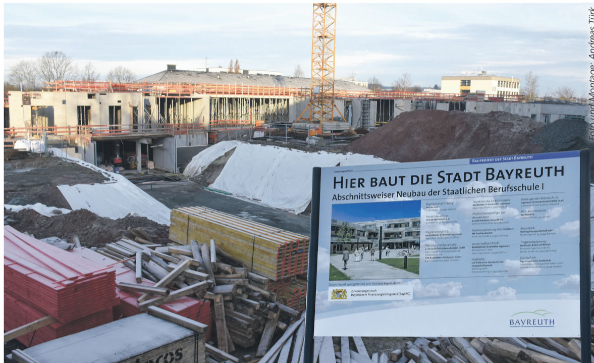
Rund 130 Millionen investiert die Stadt Bayreuth in den Neubau der staatlichen Berufsschule.
